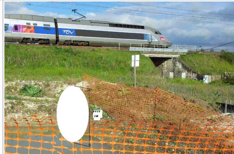
passage possible de buse sous voie (fonçage)-coté base SNCF- pour éviter siphon. bassin rétention=mare aux canards ! illégale !
