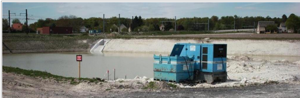
12/4/2014 Bassin avec le groupe moteur-pompe amené par COSEA , et qui était destiné à vidanger dans notre étang D 1075 (essai raté le 11 avril !) le maire M.M. Jouzeau .est intervenu pour faire cesser la vidange car le pont RD109 était noyé.
